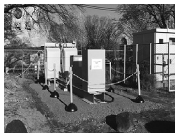
図6 LPガス発電機
