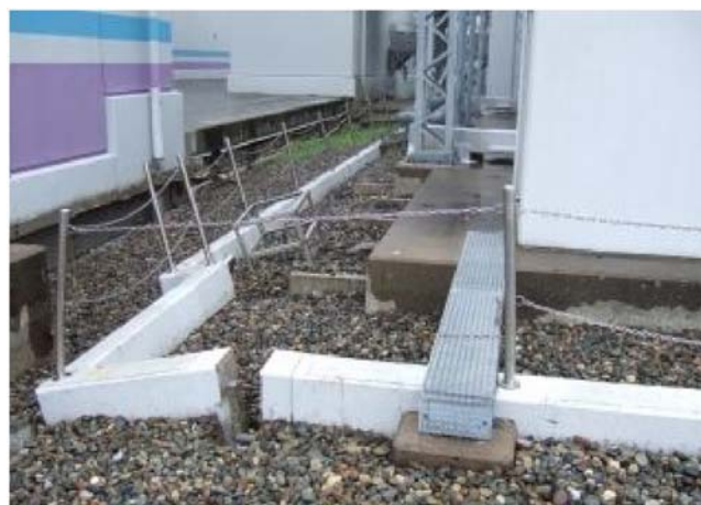
写真-3.4.3 4号機 主要変圧器防油堤の沈下、傾斜 (東京電力(株)提供)
