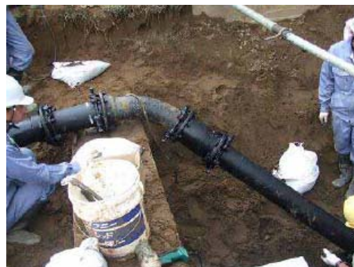
写真-3.4.2 消火系配管の応急復旧状況 (出典：原子力・安全保安部会) 1)
