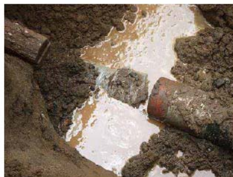
写真-3.4.1 消火系配管の損傷状況 (出典：原子力・安全保安部会) 1)
