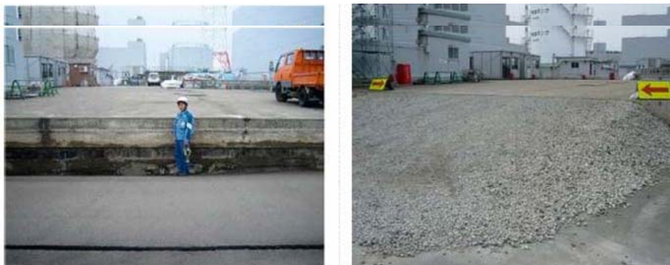
写真-3.4.5 建屋近傍の埋戻土の沈下・仮復旧状況（地震直後と現在） （東京電力(株)提供）
