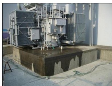
写真-3.3.4 1号機励磁変圧器 (東京電力提供)
