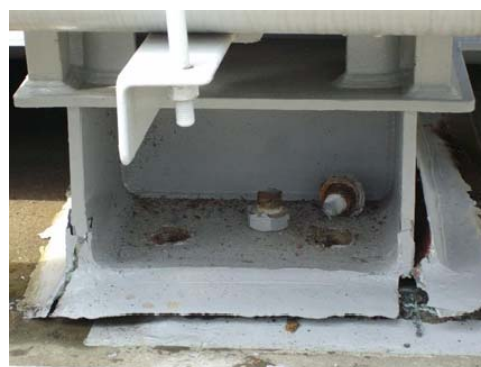
写真-3.3.3 基礎ボルト折損による変圧器の滑動 (東京電力㈱提供)
