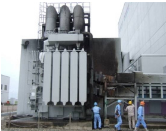
写真-3.3.1 3号機所内変圧器(3B)被災状況 (東京電力㈱提供)
