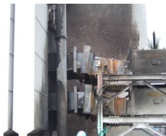
写真-3.3.2 3号機所内変圧器(3B)ダクト落下状況 (東京電力㈱提供)
