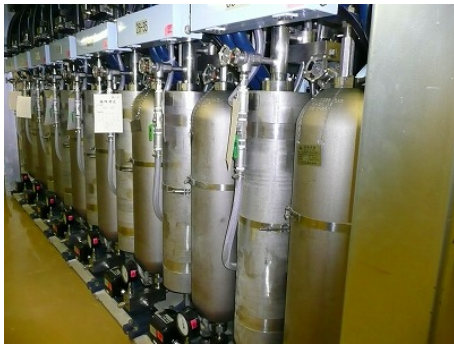
写真-3.1.7 4号機水圧制御ユニット(東京電力(株)提供)
