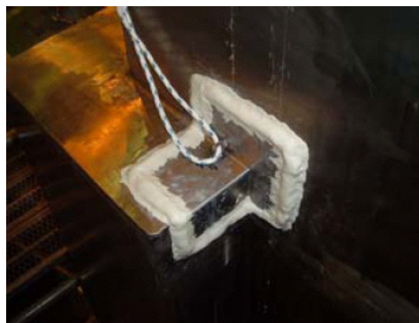
仮補修後の漏洩部(現在は補修溶接済)
