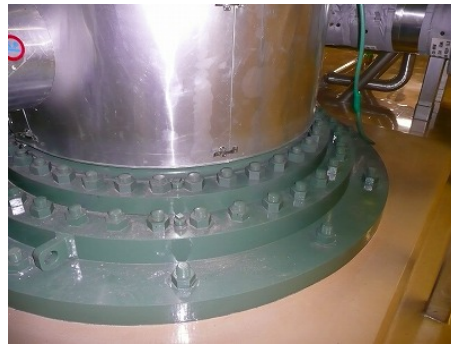
写真-3.1.8 4号機残留熱除去系ポンプ基礎(東京電力(株)提供)
