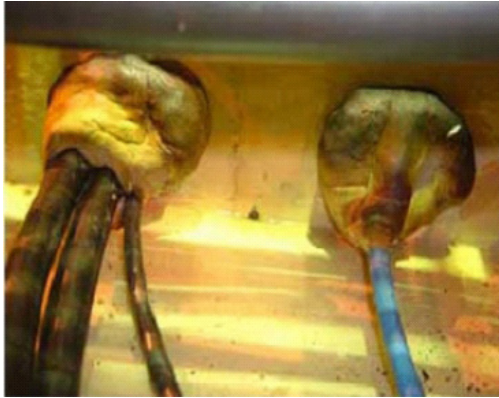
地震直後(シール部に隙間があった)
