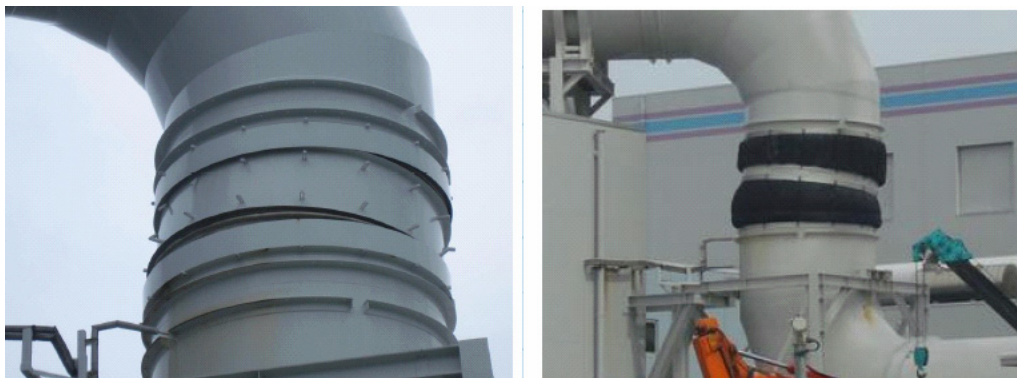
地震直後(接続ダクトのずれ)
