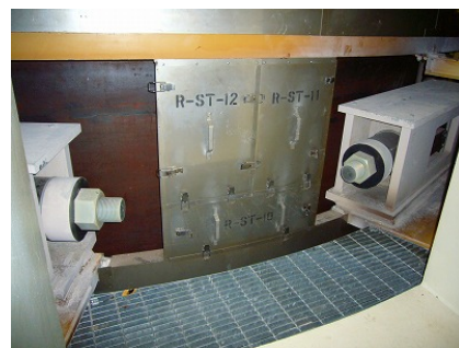
写真-3.1.10 7号機原子炉圧力容器スタビライザ(東京電力(株)提供)
