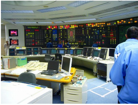
写真-3.1.13 中央制御室（東京電力(株)提供）
