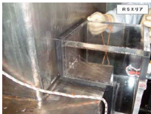
地震直後(漏洩検査中)
