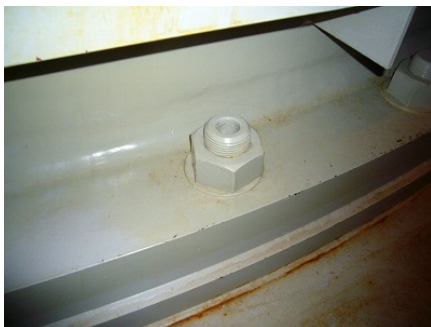
写真-3.1.9 4号機原子炉圧力容器基礎ボルト(東京電力(株)提供)
