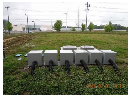
地熱発電システムの実証フィールド
