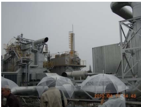
バイオ発電プラント
