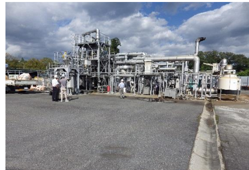
写真2 プラントの全体
