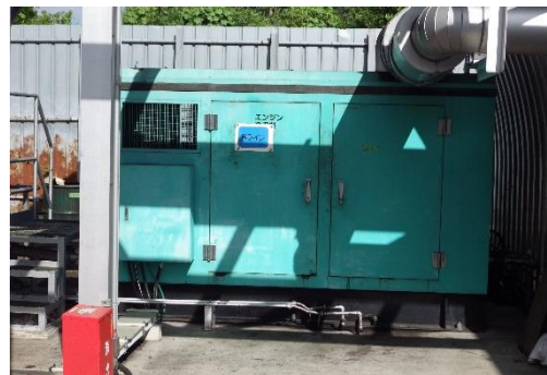
写真3 エンジン発電機(韓国製)
