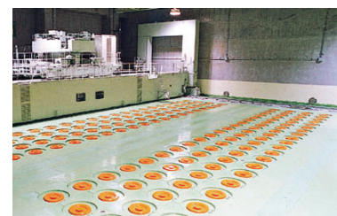
c) ガラス固化体貯蔵ピット 1)
