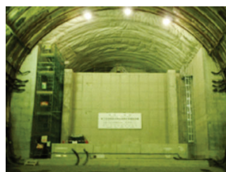
b) 地下空洞型処分施設試験設備 2)
