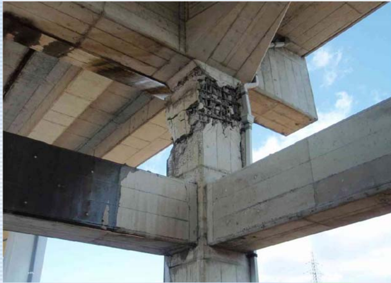
高架橋損傷状況
