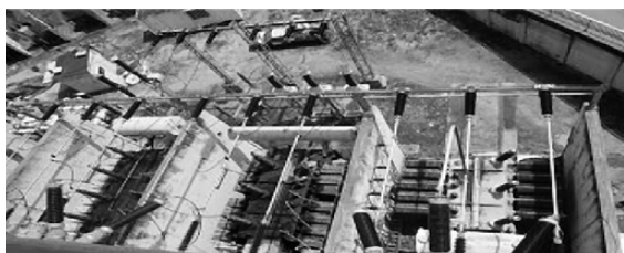
写真1 アパパロード変電所の老朽化した施設 (50%故障)
