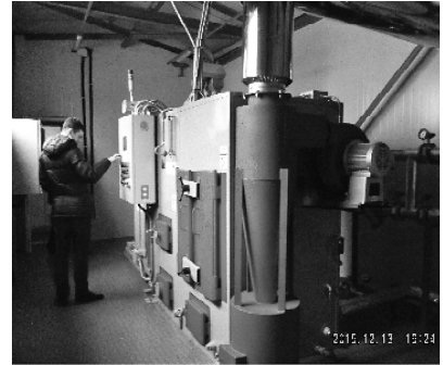
写真 5(c) ボイラーモジュール内部
