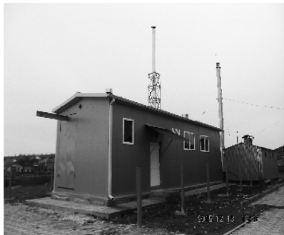
写真 5(d) ボイラーモジュール
