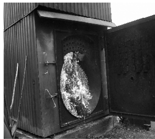
写真2(b) 稼働中の開扉
