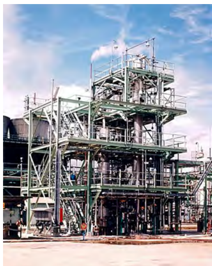
写真 1 10 t/d パイロットプラント
