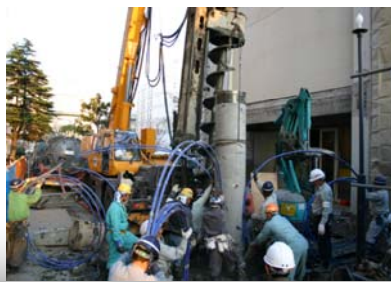
▲地中熱利用空調システム
