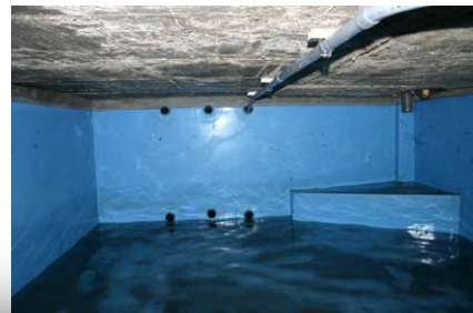
▲雨水排水再利用システム
