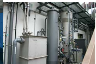
▲沈砂槽と逆洗水槽
