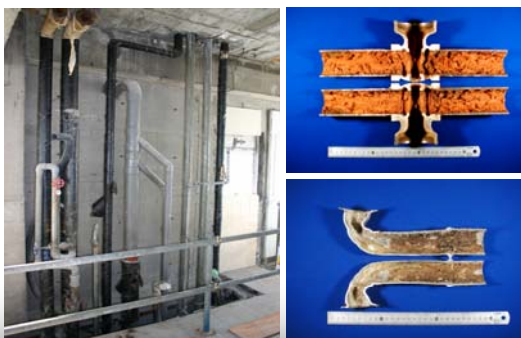
▲PS内配管と既設給排水設備配管の劣化状況
