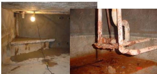
▲地下蓄熱槽内の劣化状況
