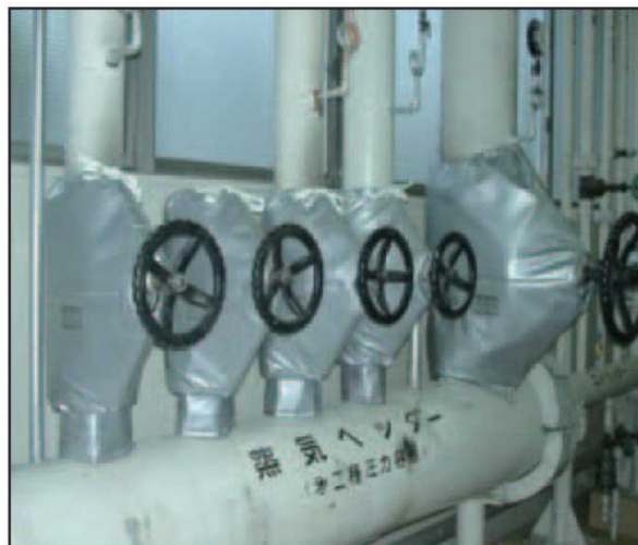
蒸気バルブの保温対策例
