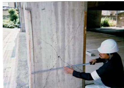
市営住宅の柱の破損現場
