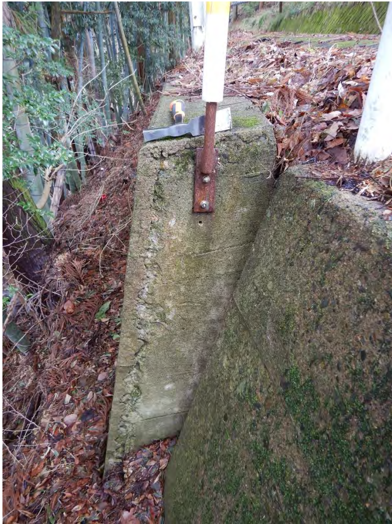
市道沿いのずれた擁壁
