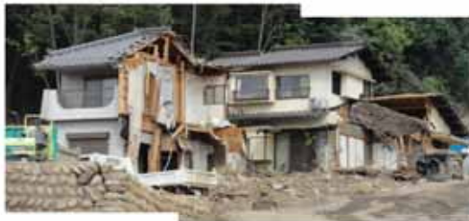
写真4 沢の右岸側の被災住宅。 土砂埋没と破損が著しい。
