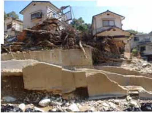
写真-2 民家前の水路と道路は完全に崩壊 3.2 安佐南区八木2
