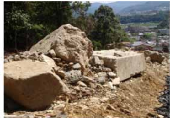
写真-4 治山事業による谷止工の崩壊
