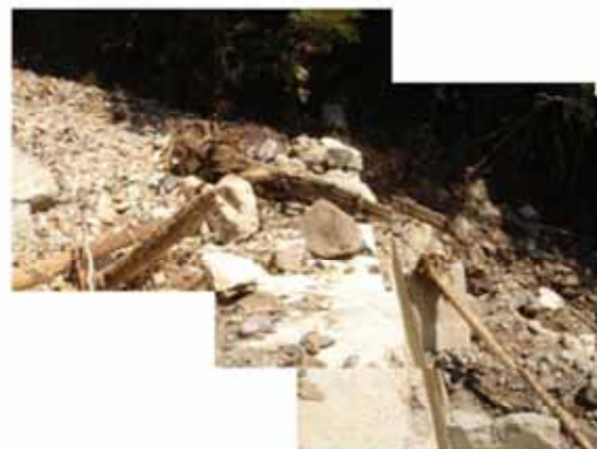
写真-5 治山堰堤の天端付近の越流土砂
