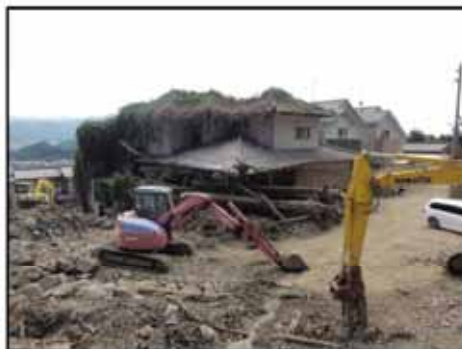
写真10 土石と流木の直撃を受けた住宅
