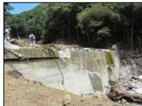
写真14 両袖が破損した治山堰堤。
