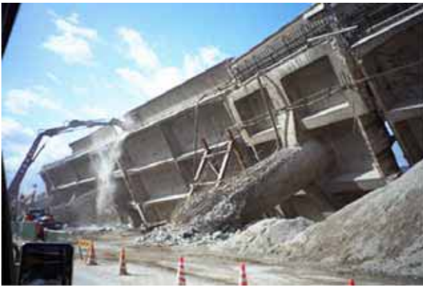
Fig. 1 道路 RC 橋脚のせん断破壊/崩壊取り壊し状況（兵庫県南部地震）
