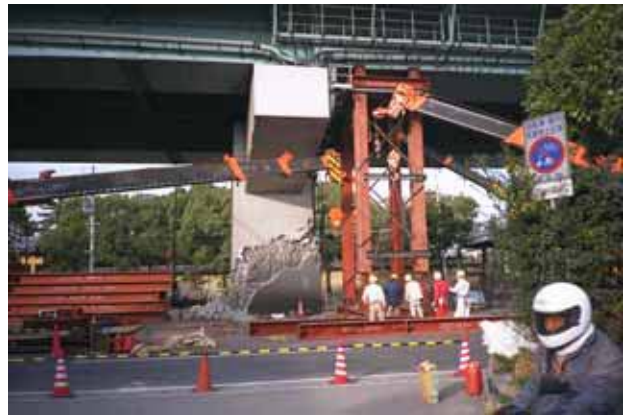
Fig. 2 道路 RC 橋脚のせん断破壊 / 応急復旧状況（兵庫県南部地震）
