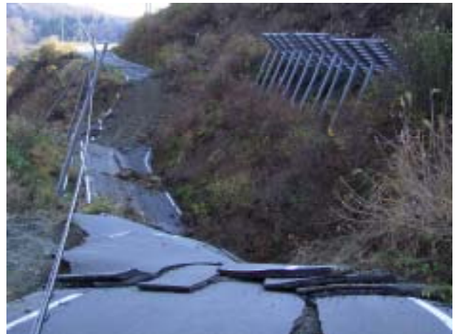
写真2 地すべりにより寸断された道路（旧山古志村）。
