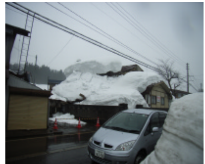
図 5 雪が重くなり歪んだ屋根(新潟県魚沼)
