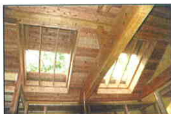
放射冷却窓半開時
