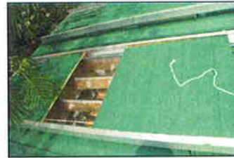
放射冷却窓半開時
