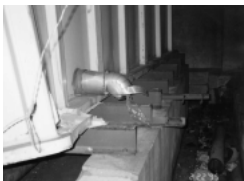
図 5.4.1 設備機械のずれ移動
