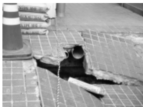
図 5.4.2 建物外周部配管破損
