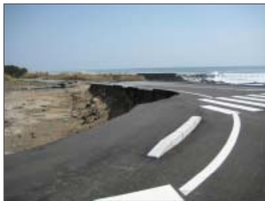
浜街道は開通間近で壊滅的被災を受けた
