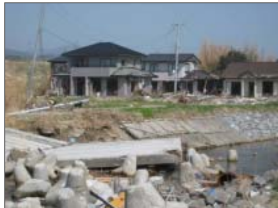
北追川護岸が津波で崩壊
