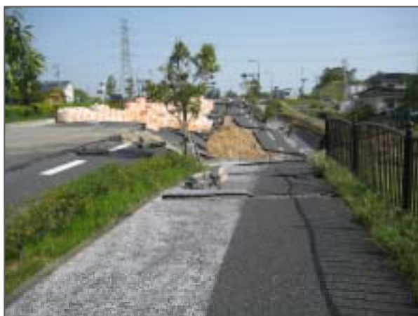
ニツ沼総合公園沿いの国道 6 号上り線が崩壊
