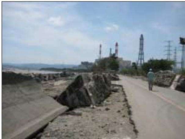
岩間町海岸護岸倒壊、常磐共同火力発電休止中
