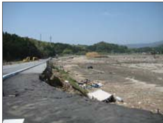
浜街道建設中の重機が転倒している
