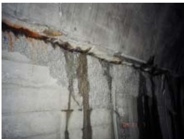
県道荒谷トンネル SPL 付近の段差的崩壊
