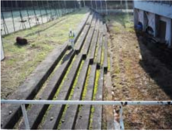
長岡高専 活断層による階段のずれ
