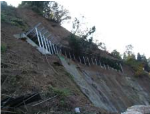
小千谷市 斜面崩落雪崩防止柵効果
