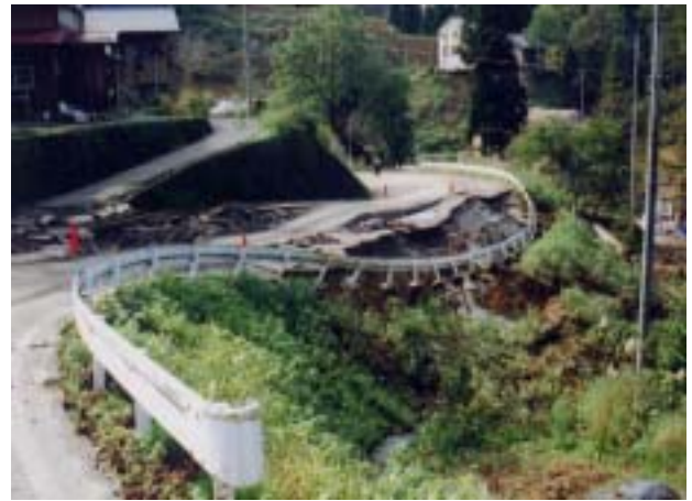
県道小栗山地区 地滑りによる道路崩壊
