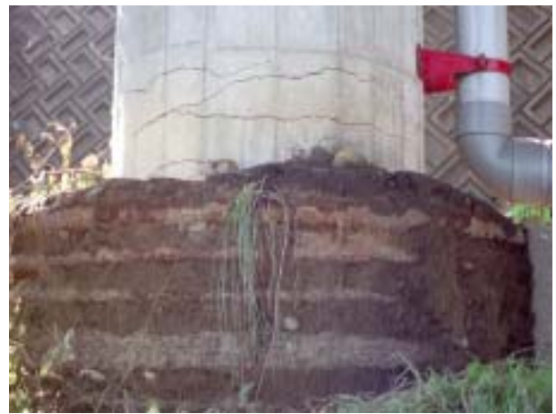
山辺橋 斜面沈下の伴い深礎杭の露出
