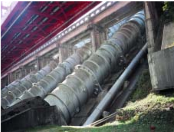
小千谷発電所ペンストック
