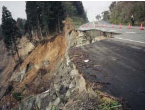
県道川口塩殿線西倉地区道路崩壊
