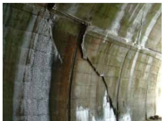
県道荒谷トンネル 斜め亀裂
