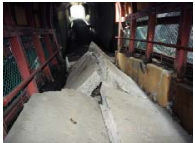
川口駅横断地下通路の損壊
