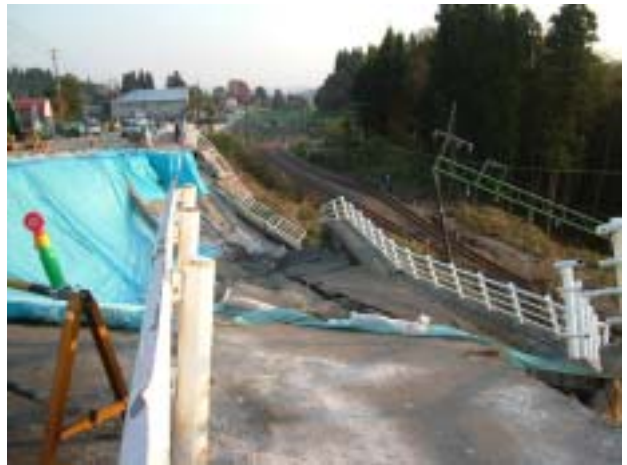
川口市天納地区 斜面崩壊に道路災害
