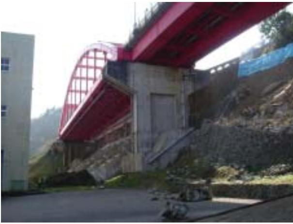
山辺橋および小千谷発電所の被害
