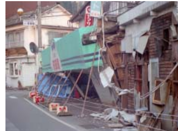
川口町 店舗の損壊
