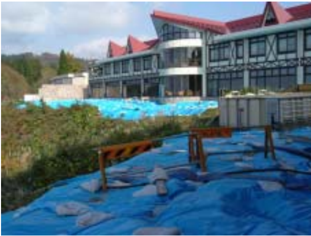
川口町 ホテル蒼丘裏地の斜面崩落
