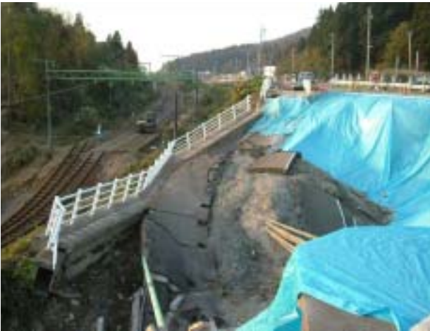
川口市天納地区 斜面崩壊に道路災害
