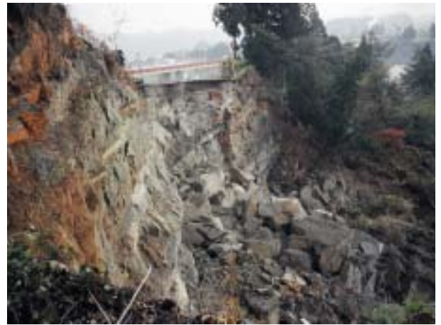
県道川口塩殿線西倉地区道路崩壊
