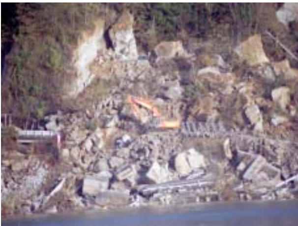
長岡市妙見地区 岩盤崩落による事項現場
