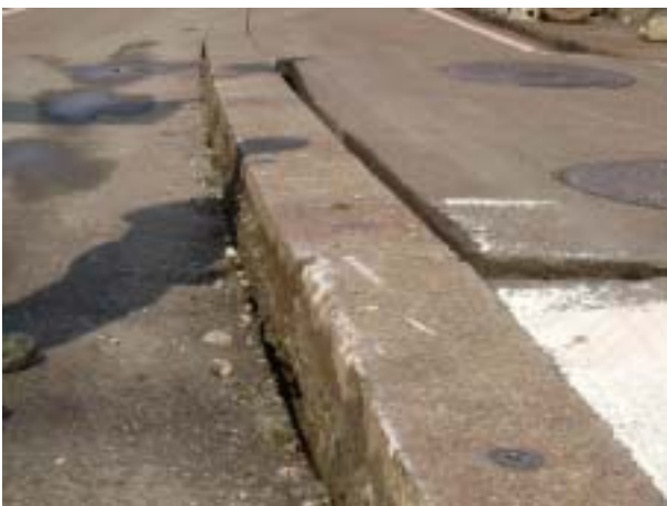
川口町 消雪施設に伴い道路沈下
