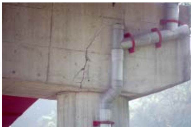
写真14 山辺橋ラーメン橋脚の塑性ヒンジ
