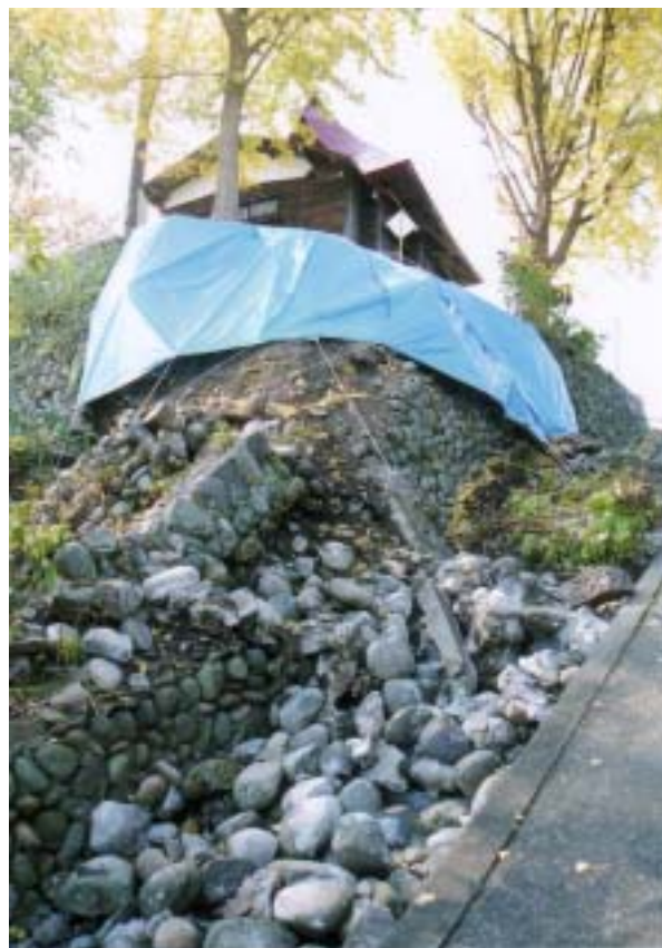
写真20 小千谷市街 急傾斜地損壊
