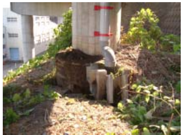
写真 13 山辺橋橋脚の深礎杭の露出
