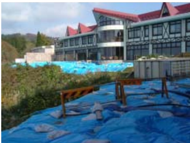
写真18 川口町 ホテル蒼丘の斜面崩壊
