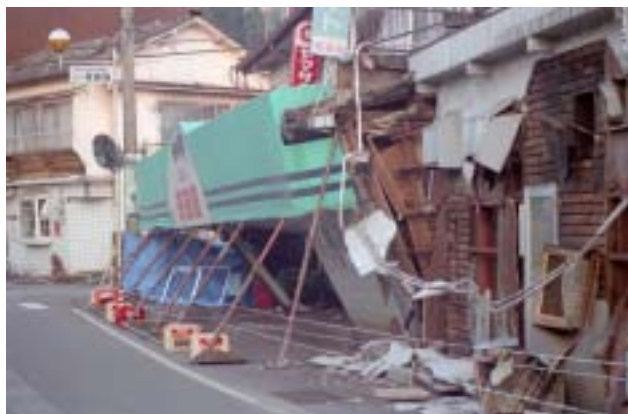
写真 2 1 川口町市街 家屋損壊
