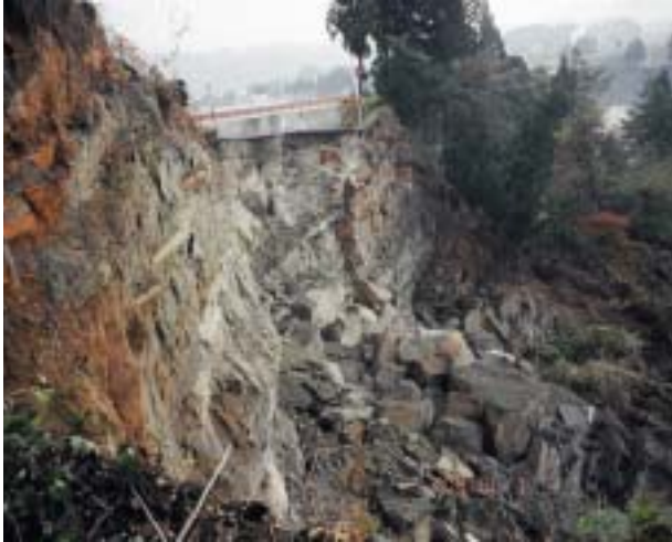
写真3 県道川口塩殿線西倉道路崩壊(2)
