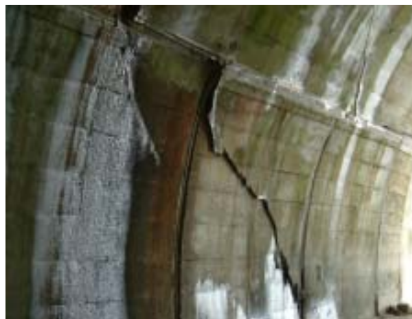
写真16 荒谷トンネルの斜め亀裂
