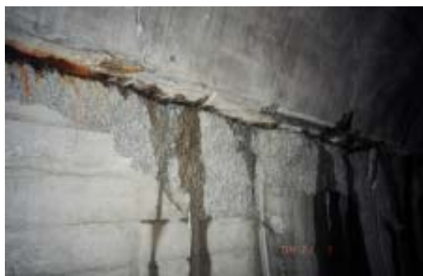
写真15 荒谷トンネルのSPLの破損
