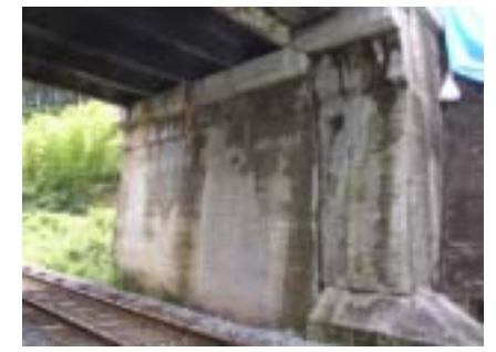
跨線橋橋台に入った亀裂 ( 国道 108 号 : 南郷町 )
