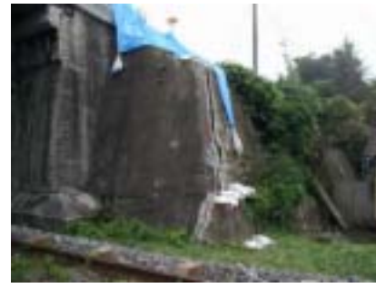
擁壁の亀裂 ( 国道 108 号 : 南郷町 )
