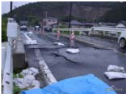
道路の陥没 ( 国道 108 号 : 南郷町 )
