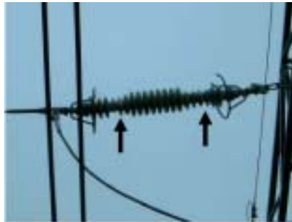
変電所碍子の損傷(矢印)
