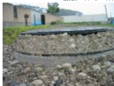
マンホールの浮上り
