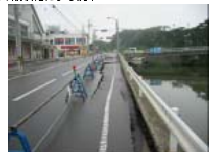
東名運河沿い道路沈下による亀裂
