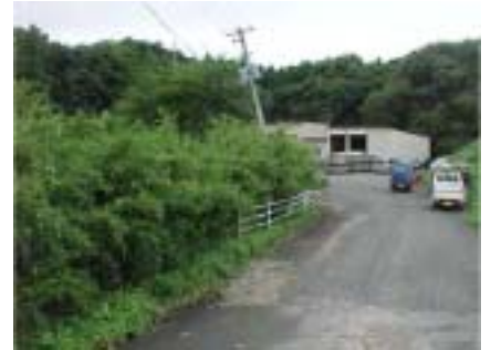
配電線電柱の傾斜
