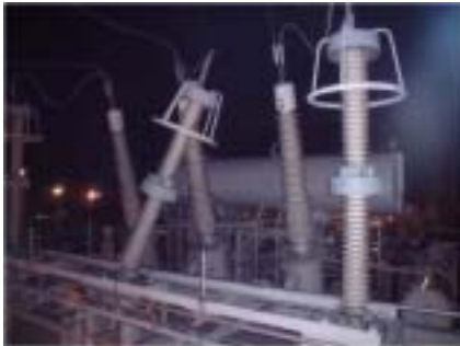
変圧器ブッシング(碍子)の損傷
