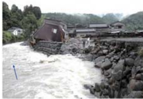
写真-2.5.2 高尾川の橋梁被害(住家被害)
