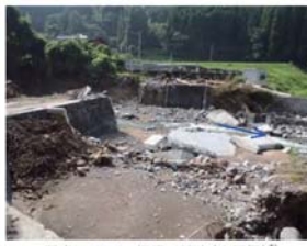
写真-2.6.4 橋梁の流出(小運橋)
