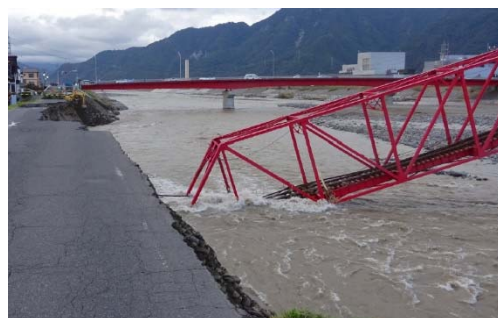
写真 2 上田電鉄千曲川橋梁の落橋(上田市)
